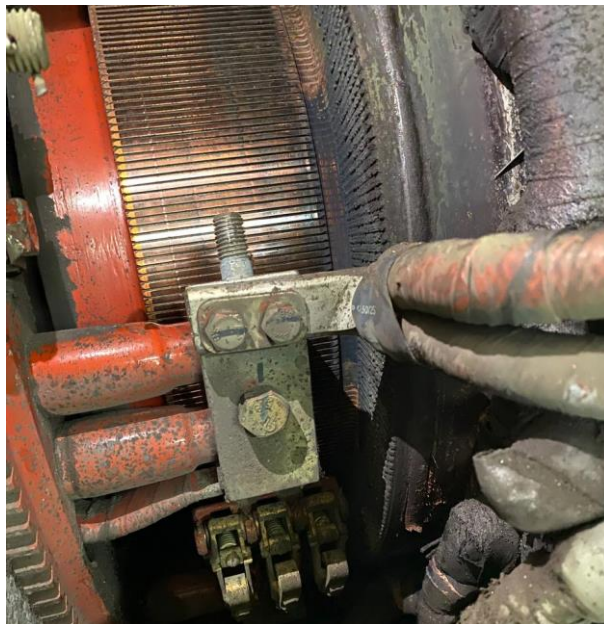
Рис. 4. Последствия искрения на коллекторе ТЭД
