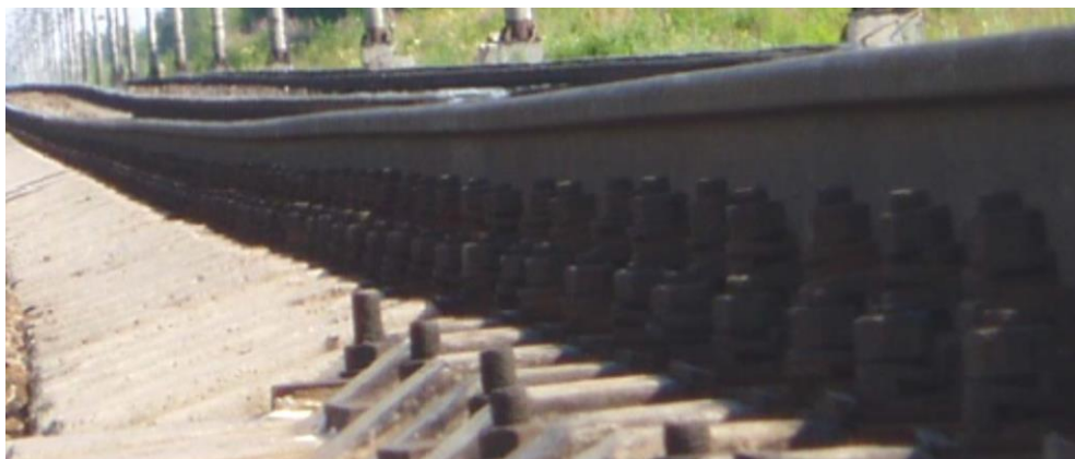
Рис. 1. Общий вид неровности на участке переходного пути переменной жесткости [4]
